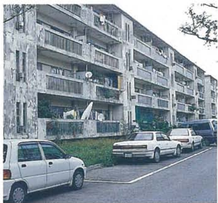
老朽化が進み、コンクリート片の落下など、危険な状態にある。再生計画に注目が集まる
