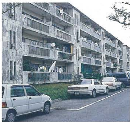
老朽化が進み、コンクリート片の落下など、危険な状態にある。再生計画に注目が集まる
